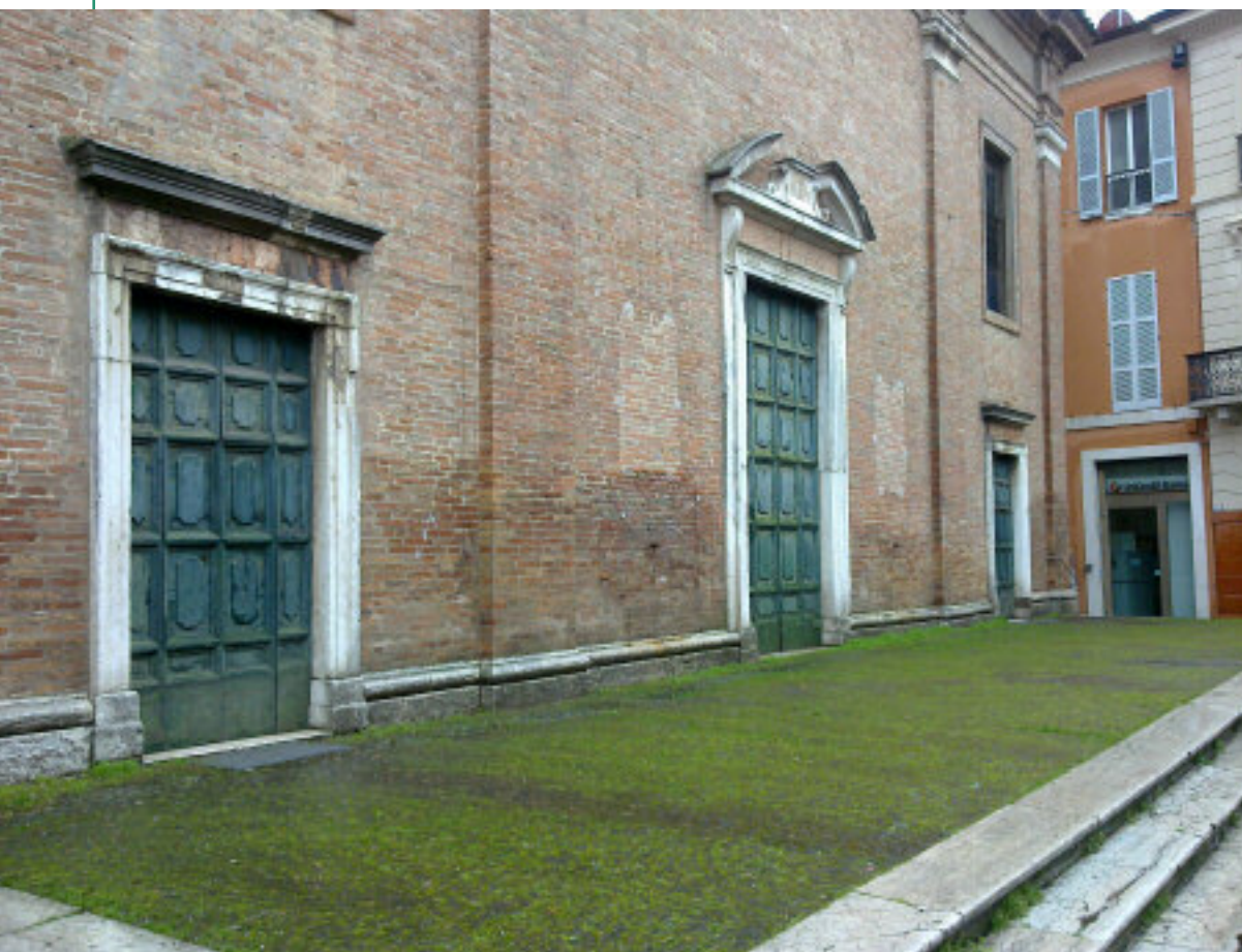
Acciottoloto di ingresso alla chiesa di Bagnacavallo (Ra), infestato da erbe.
